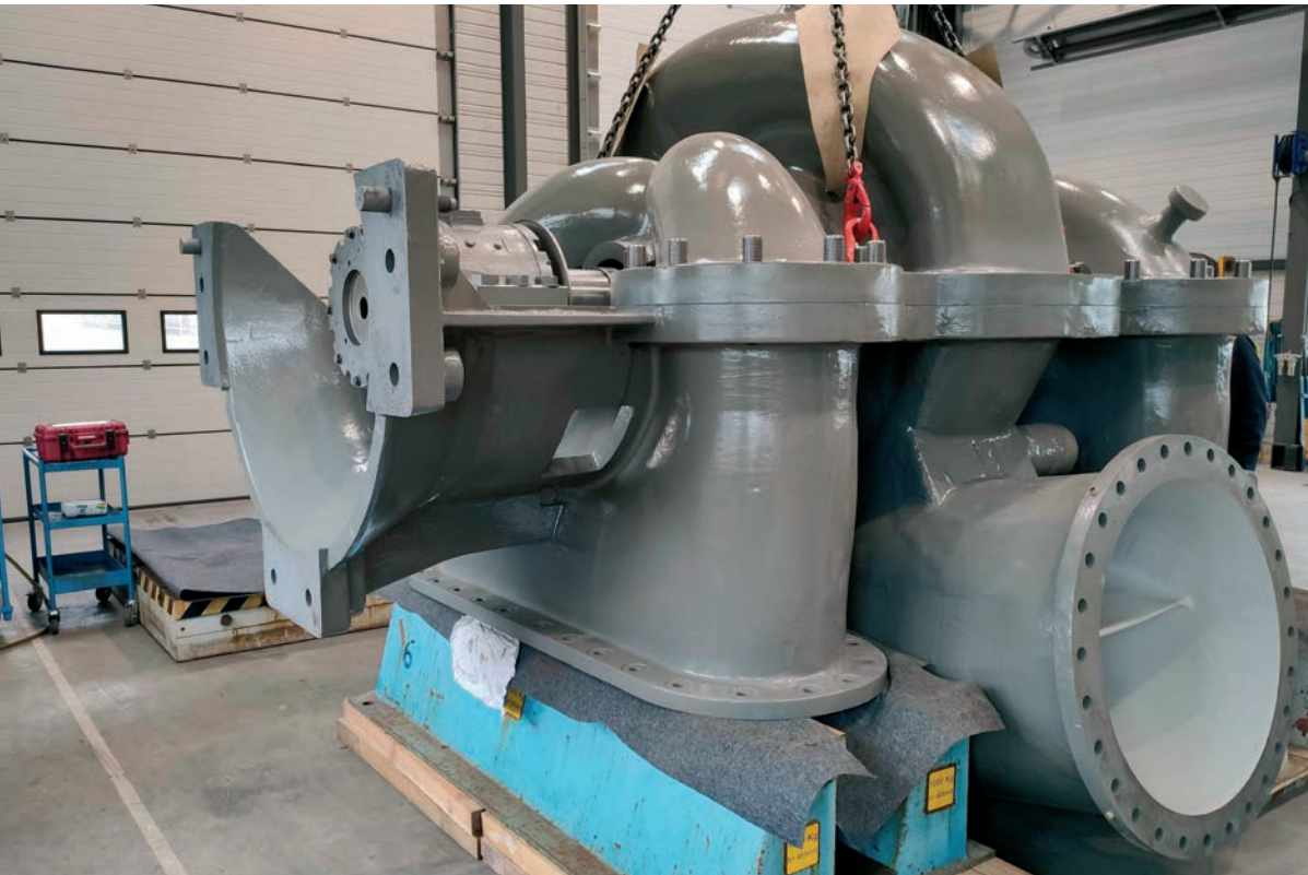
Pompe ELP 9 entièrement rénovée, prête pour son retour à l'usine de Choisy-le-Roi
