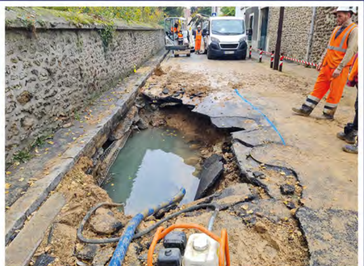
Morsang-sur-Orge, une fuite dominicale sur une canalisation de 400 mm de diamètre bloque la circulation.
