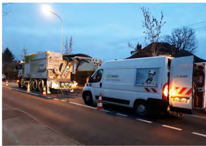
Fuites en série sur canalisation défectueuse à Yerres, nos équipes en intervention jour et nuit.
