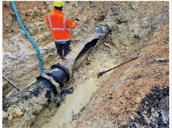
Fuite d'eau marquante sur le réseau de transport à Créteil. Pas de manque d'eau grâce au maillage et interconnexion.
